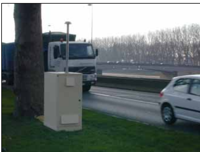
Photo 1 : Armoire localisée à 2 mètres de la voie des berges
