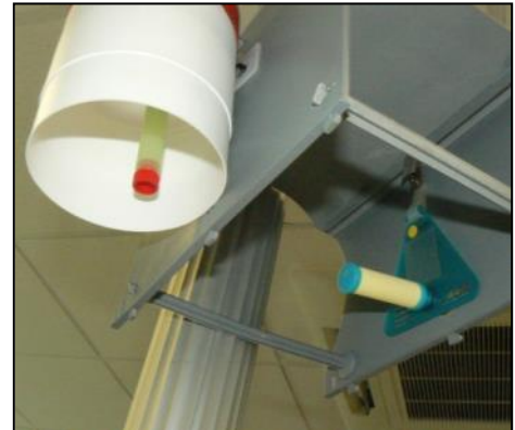
Photo 1 : tubes installés pour la collecte
