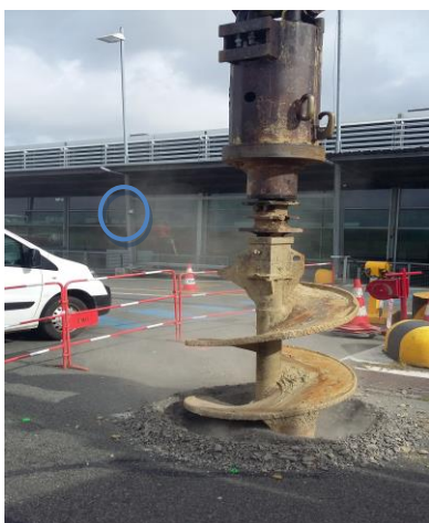
Site 14 : travaux de terrassement pour le déplacement de 5 mats d'éclairage sur le parking LIMA situé devant le hall n°4
