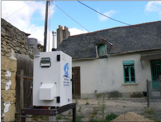
Photo 2 : collecteur moyen débit dans le bourg de Martigné Briand
