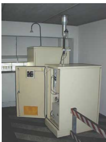
Station de mesure d'Air Pays de la Loire composée de deux armoires abritant les analyseurs automatiques
