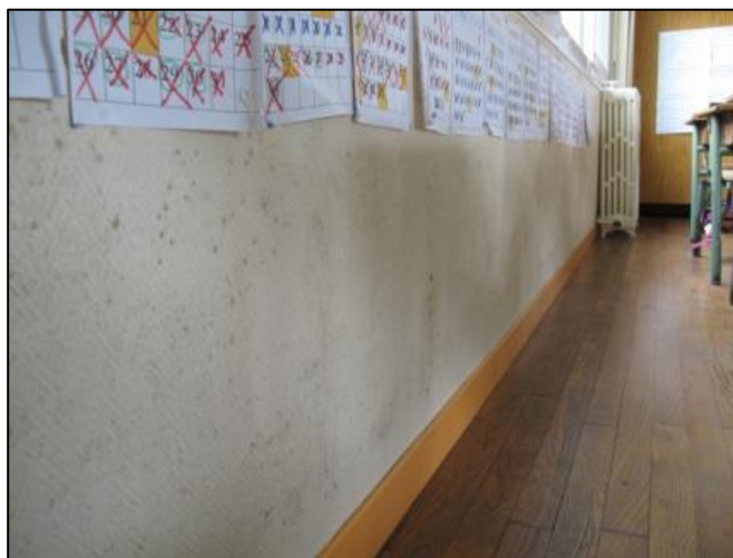
Photo 12 : contamination fongique sur le mur de la salle d'enseignement de CE1 (10/06/2013)
