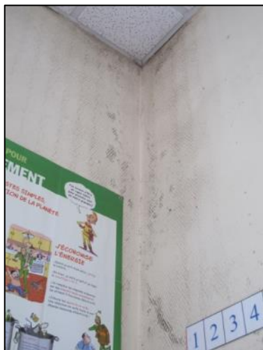
Photo 11 : contamination fongique sur le mur de la salle d'enseignement de CE1 (10/06/2013)
