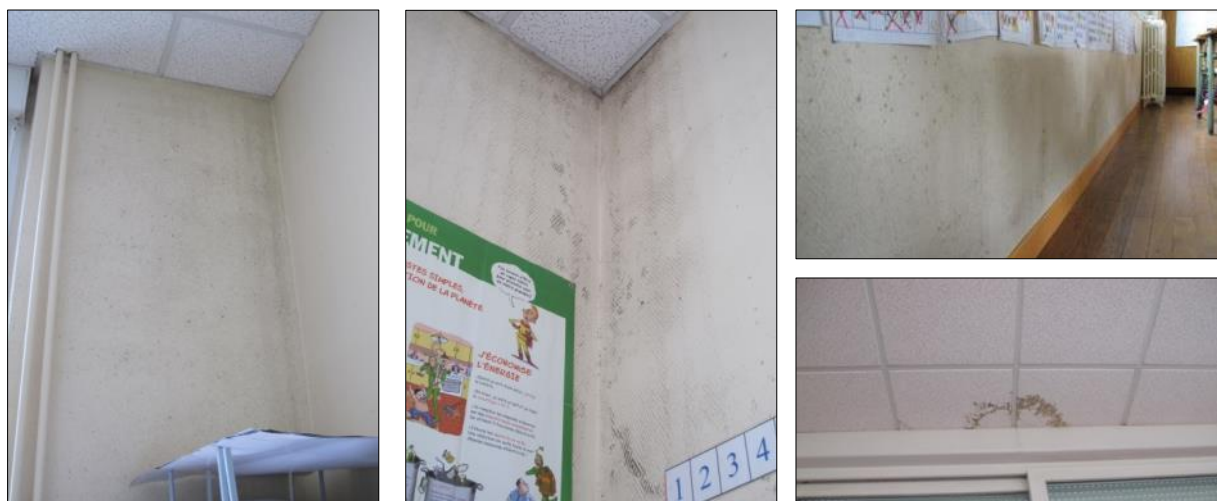
Contamination fongique dans la salle d'enseignement de CE1
