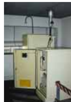
Armoires abritant les analyseurs automatiques de pollution
