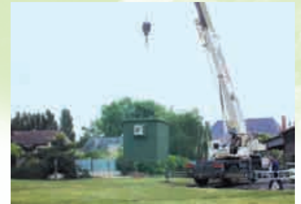
Installation du site de mesure de Spay
