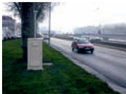
Armoire de mesure sur la voie des Berges à Angers
