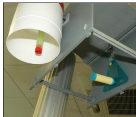
Tubes installés pour la collecte
