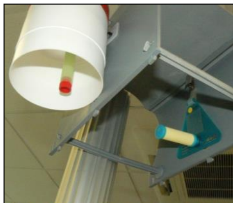
Tubes installés pour la collecte
